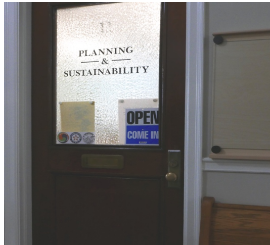
Noncompliant door hardware, knob handles
